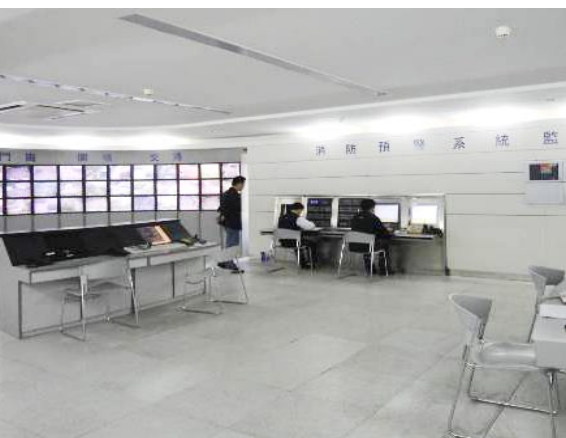
集团消防监控中心
