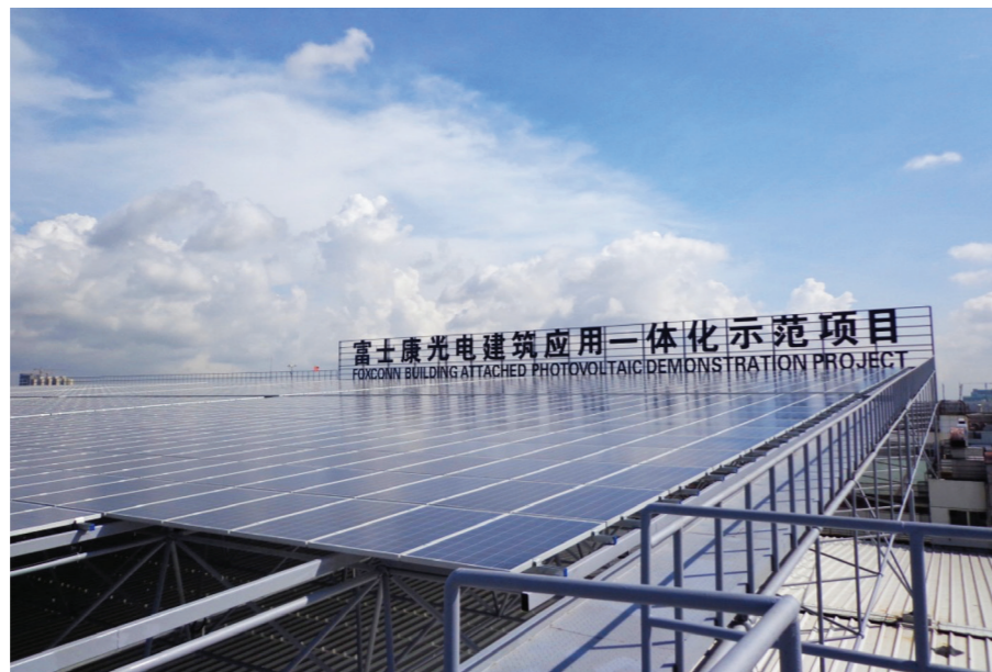
龍華園區光電建築一體化太陽能光伏工程
